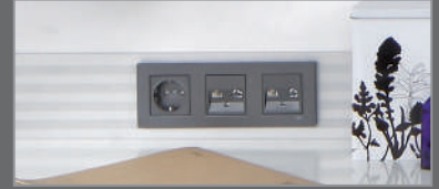
Kablo Kanalı, Priz
